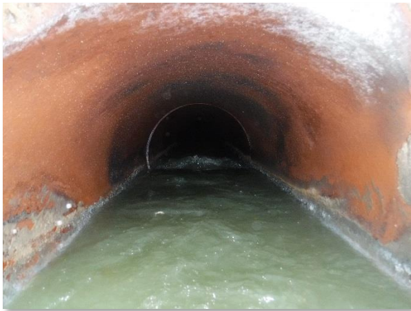
Effluent Pipe - 2336 Monroe St
