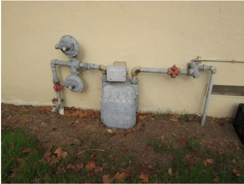
23. Natural gas meter
