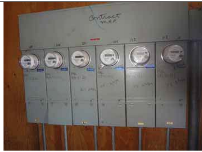
51. Tenant space electrical meter bank
