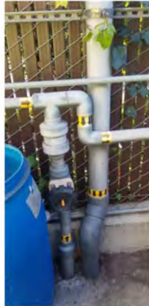
Intersil GWET Influent & Effluent Manifolds
